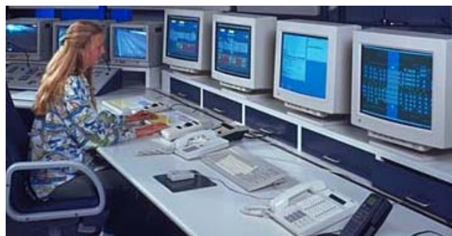
Figur 3.7: Kontrollrom i distribuert styringssystem
